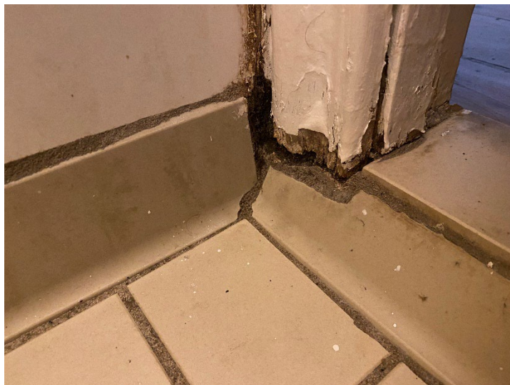
Foto 16. Nedbrudt og frønet træværk ved badeværelsesdør. Hul indtil den bagvedliggende etageadskillelse.
