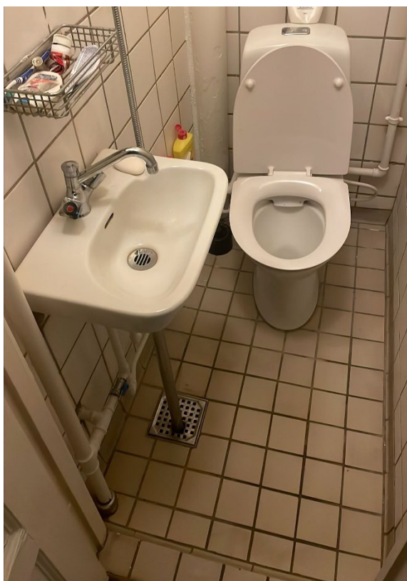
Foto 63. Rørgennemføringer i vådzone.
