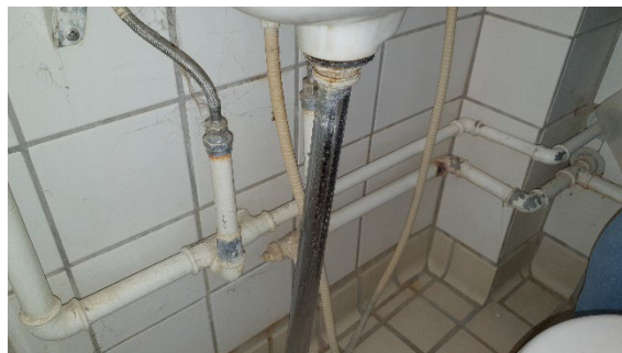
Foto 56. Koblingslednigner i badeværelse. Der er gennemtæring i en bøjning.
