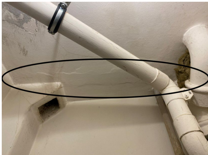
Foto 3. Revnemønster på loft i baderum der kunne indikere et rustangreben bærejern.
