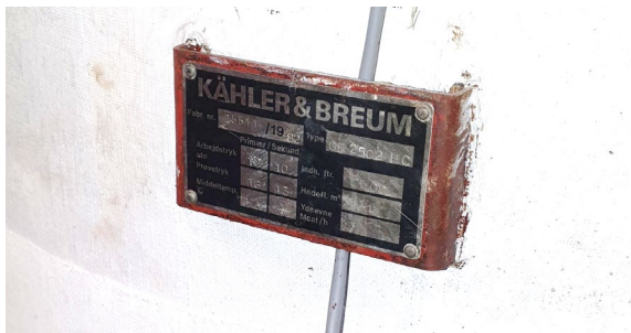
Foto 41. Mærkeplade på varmtvandsbeholdere.
