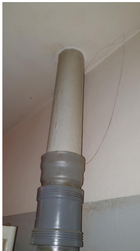
Foto 26. Faldstamme i støbejern med partiel udskiftning til PP rør. Der er ikke foretaget sikring imod brand.
