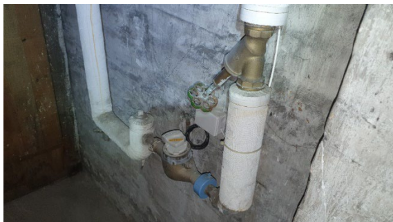
Foto 35. Vandmåler ved Christiansmindevej 5. Der mangler den lovpåkrævede sikring imod tilbagestrømning.
