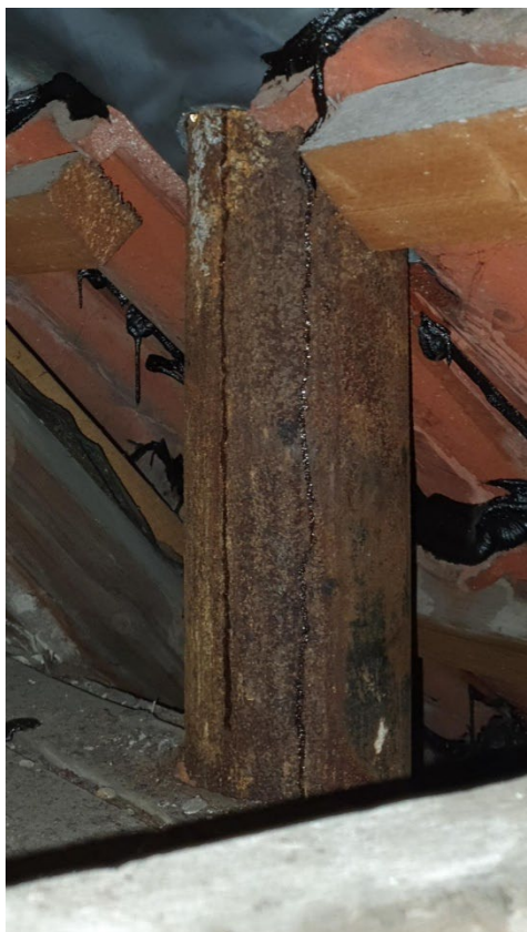
Foto 25. Faldstammeudluftning i loftrum. Faldstammen fremstår med meget udvendig korrosion.
