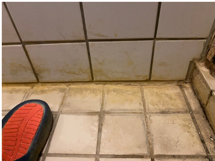
Foto 7. Nedbrudte elastisk fuger med fugeslip i overgang mellem gulv og væg.
