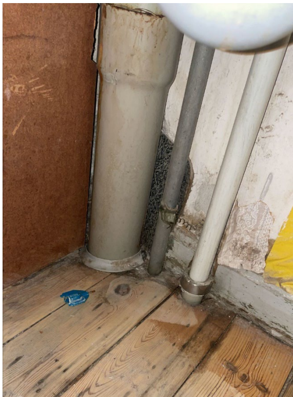
Foto 59. Rørgennemføringer i køkkenskab. Koldt og varmt brugsvand, samt faldstamme.
