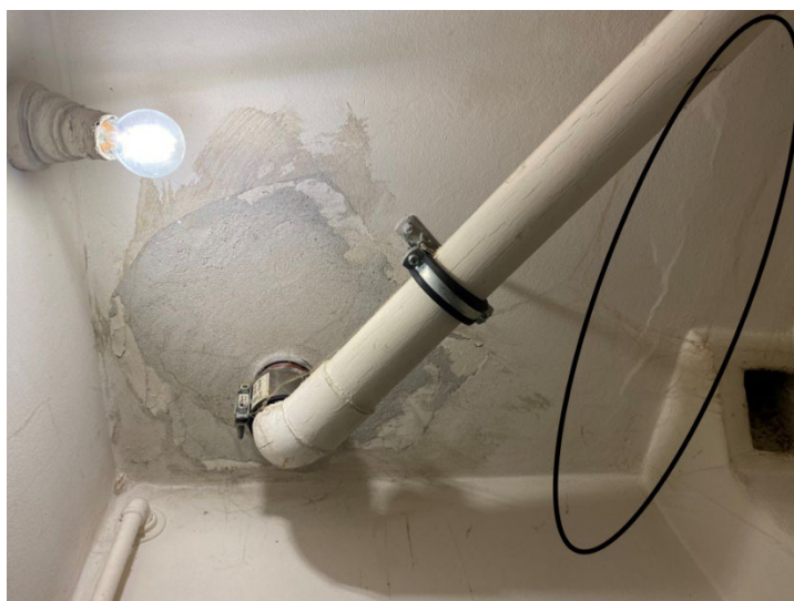
Foto 4. Revnemønster på loft i baderum der kunne indikere et rustangreben bærejern.
