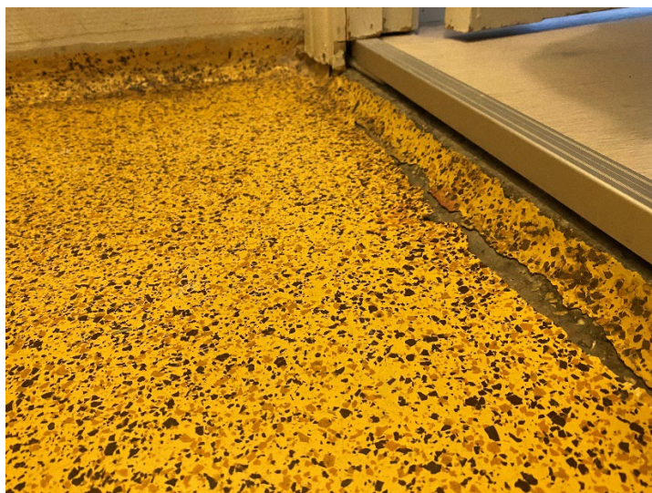
Foto 10. Ødelagt og revnet belægning. Tidligere anvendt banevarebelægning
