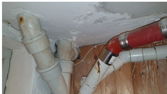
Foto 20. Faldstamme med partiel udskiftning af grenrør fra gulvafløb. Der er synlige udblomstringer.
