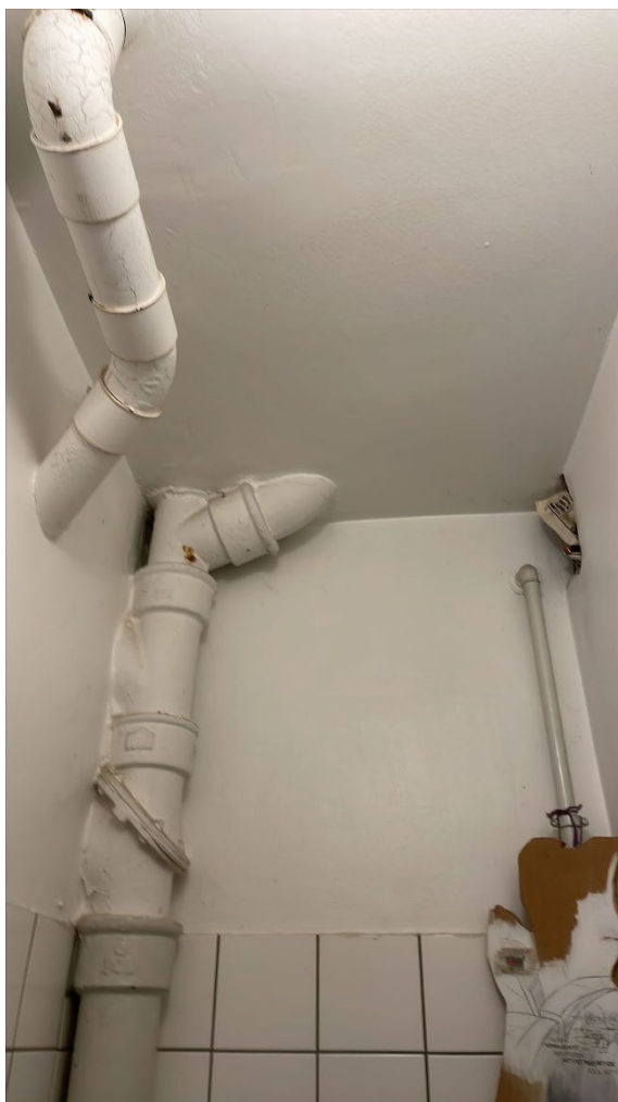
Foto 33. Faldstamme med udblomstringer ved tilslutning af toilet og gulvafløb.
