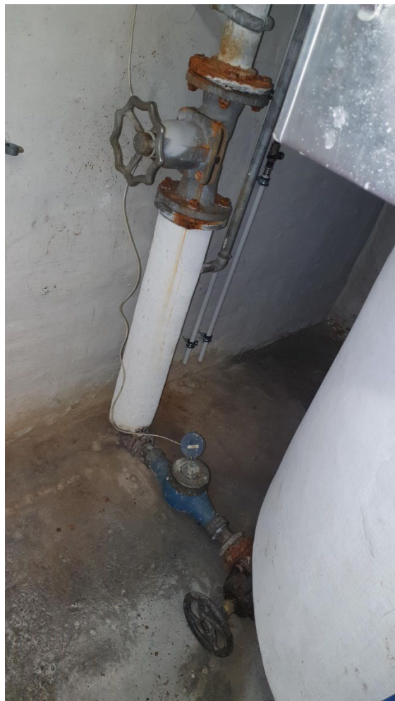
Foto 46. Vandmåler ved koldtvandstilgang til forvarmer beholder.
