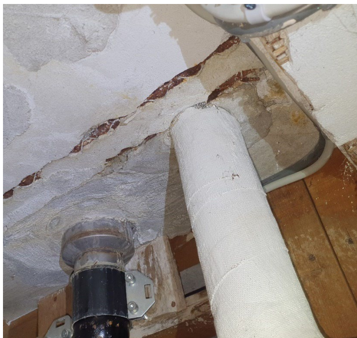
Foto 5. Rusten bærejern under badeværelse i kælder
