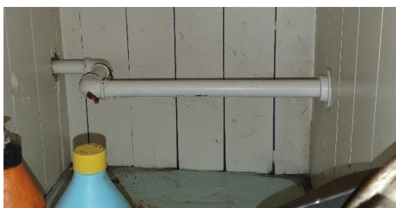
Foto 47. varmt brugsvandsrør i køkkenskab. Røret har en tæring i bøjningen.
