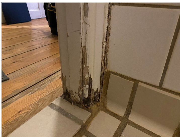
Foto 15. Nedbrudt og frønnenet træværk ved badeværelsesdør.
