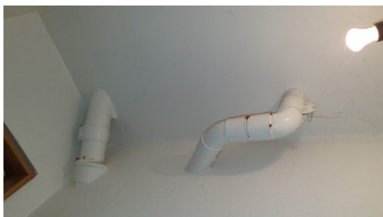
Foto 29. Grenrør fra overbo løber ind til faldstamme i naboelighed. Der er mange udblomstringer.
