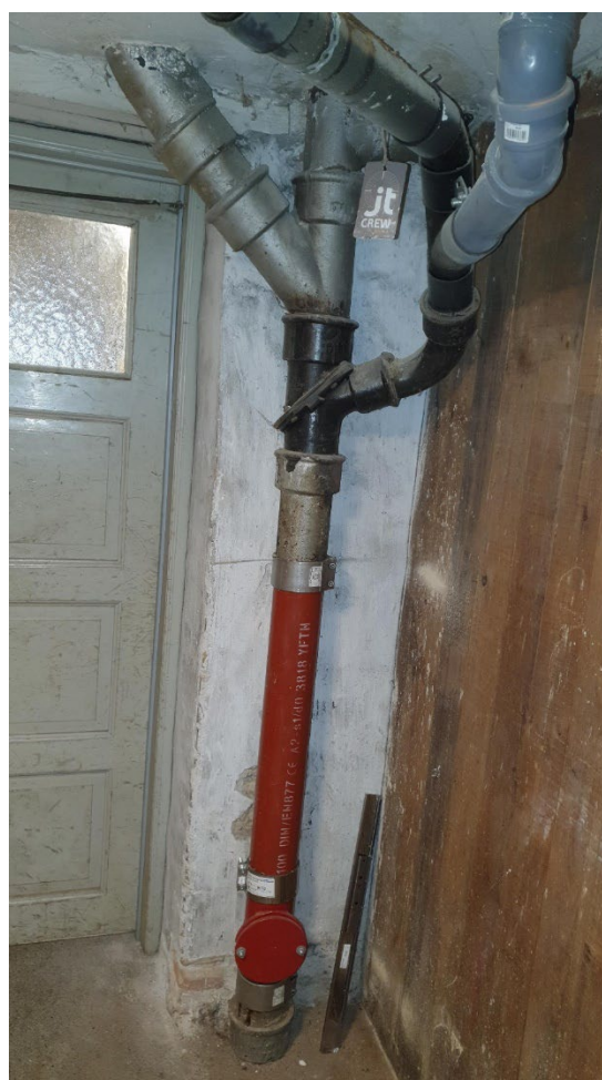
Foto 22. Faldstamme med partielle udskiftninger i forskellige materialer. Grenrøret fra gulvafløbet er udført i PP uden brandsikring med brandmanchet.
