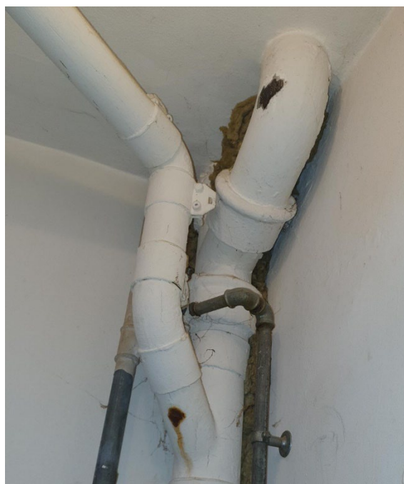
Foto 52. Stigstreng for brugsvand placeret omkring faldstamme. Heller ikke her er det nemt at holde området rent.
