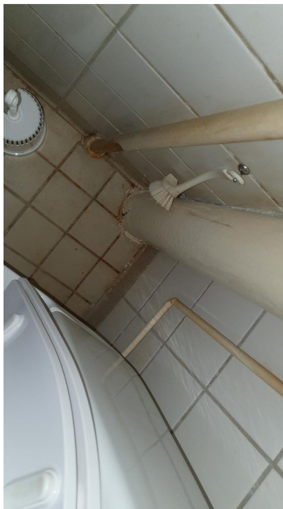
Foto 34. faldstamme og brugsvandsrør ved toilet. Ved udskiftning kan eksisterende hul ikke genanvendes pga. nødvendig brandsikring, så faldstammen skal flyttes ind i rummet.
