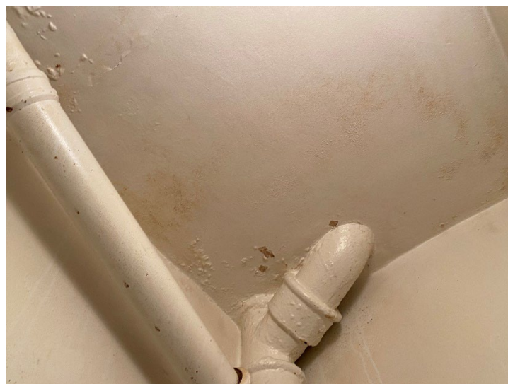
Foto 6. Bobler i og afskalling af maling på loft.
