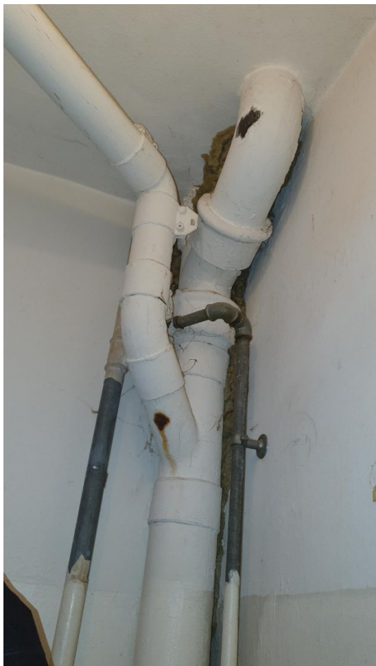
Foto 27. Faldstamme i badeværelse med større udblomstringer.
