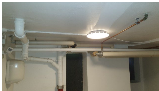
Foto 24. faldstamme med grenrør i PP fra håndvask. Der er ikke foretaget brandsikring med brandmanchet.
