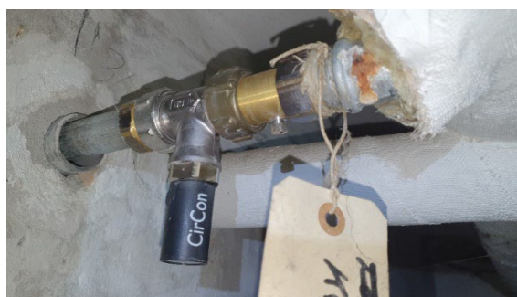
Foto 38. Termostatisk cirkulationsventil. Der er tæring ved samlingen mellem galvaniseret stål og messing.
