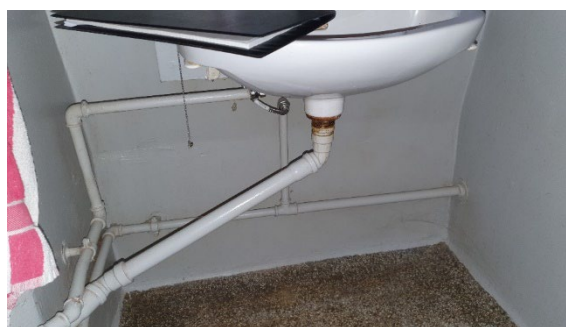
Foto 48. Badeværelse med synlige vandrette rør.
