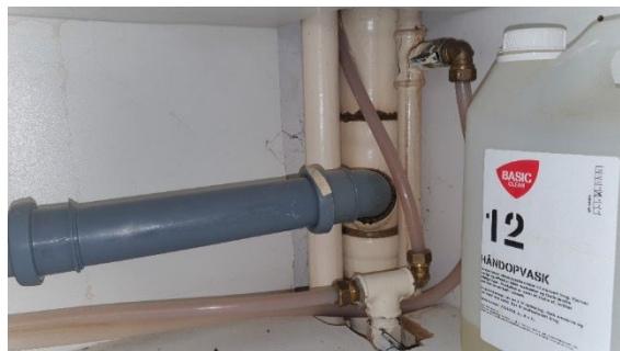
Foto 50. Pexrør med Messing fittings. Denne løsning giver øget risiko for tæring grundet migration.
