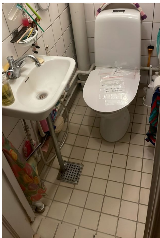
Foto 64. Rørgennemføringer i vådzone.
