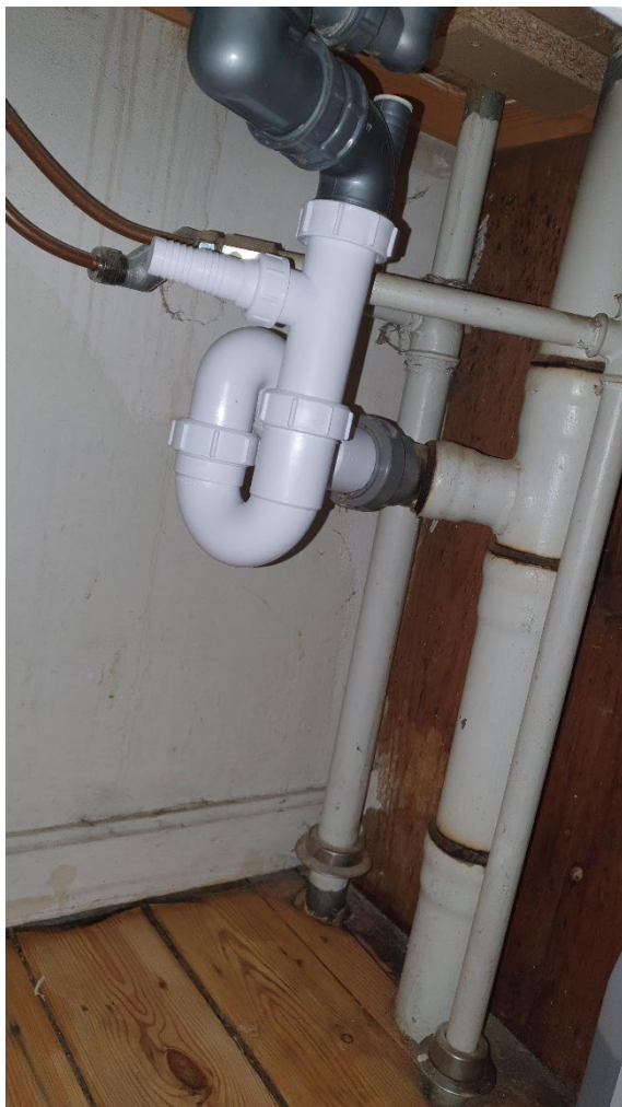
Foto 57. Rørgennemføringer for to stigstreng og en faldstamme i køkkenskab.
