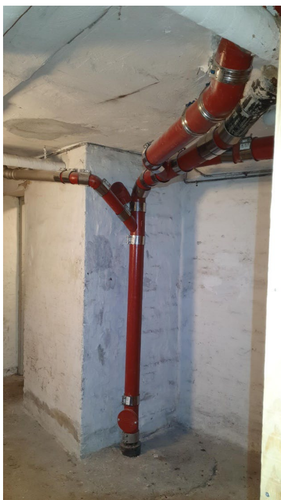
Foto 21. Faldstamme i kælderen. Faldstamme fra badeværelser. Der er renselem i bunden af faldstammen.
