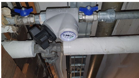
Foto 39. Strengreguleringsventil med termometer som viser 48 °C. Temperaturen skal være 50 °C i hele vandbanen.
