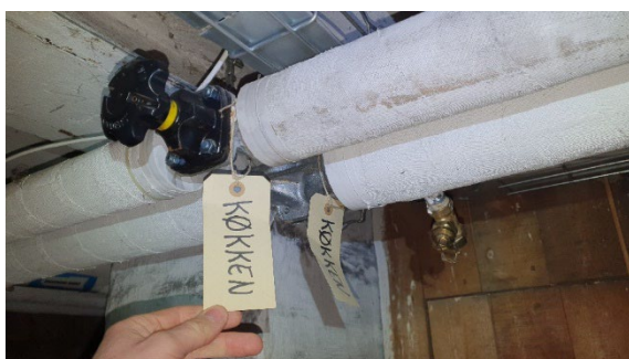
Foto 37. Afgrening fra fordelingsrør i kælderen til stigstrengene.
